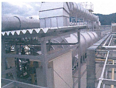
灯油から天然ガスに燃料転換しCO 2 排出量削減へ寄与した有機溶剤脱臭炉
