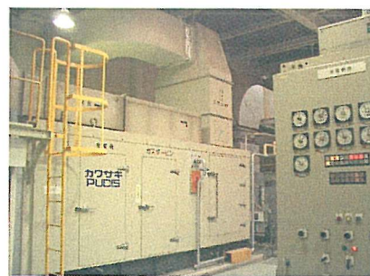
重油から天然ガスに燃料転換しSO x 排出量を“0”にしたコージェネレーション設備
