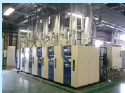
貫流ボイラ外観
