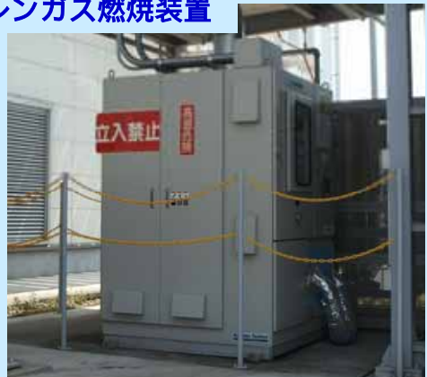
酸化エチレンガス燃焼装置
