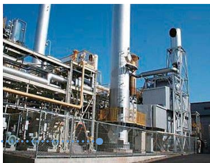
ガスタービンコージェネレーション設備
