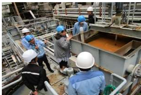
排水処理施設を見学
